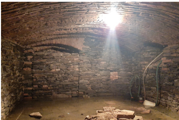
Sklepení s velmi zachovalou konstrukcí stěn i stropu. Vzadu vlevo je vidět zazděný vstup do dvorní části sklepa
