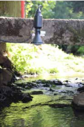
Hladinoměr - pomocí ultrazvukových vln měří průběžně hladinu vody a stav po 1 minutě zaznamenává. Při dosažení určité hranice rozešle SMS zprávy krizovému a povodňovému štábu.
