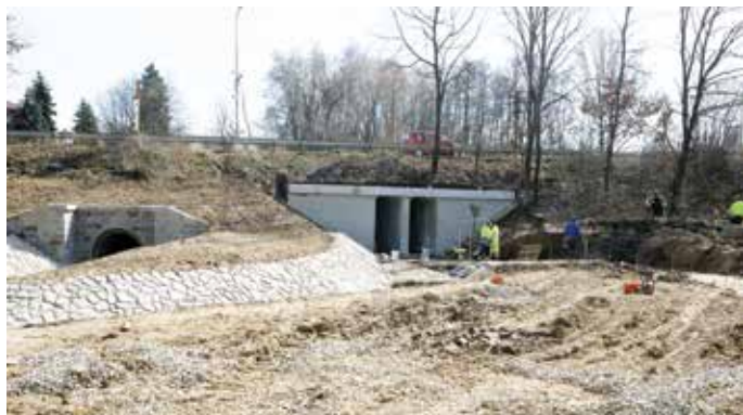
Stavba pokračovala především v úseku u propustku pod ulicí Říčanská, kde stavbaři svedli potok do potrubí, aby původní místo průtoku sloužilo v budoucnu pěším a cyklistům. Pohled směrem od věznice na Říčany.
