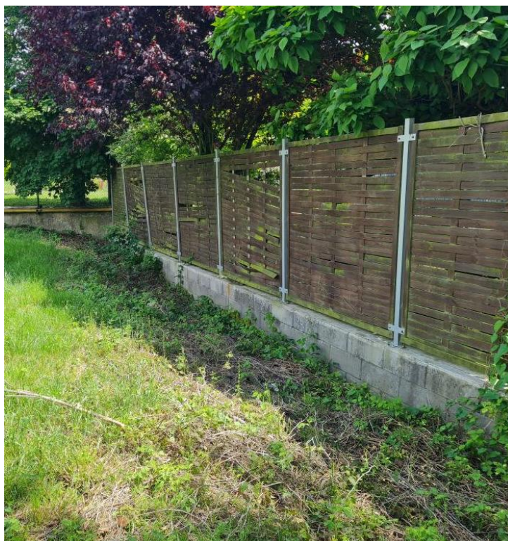
Obrázek 6: snížený terén u podezdívky tvoří navážka, bude potřeba ověřit vhodnou hloubku základů
