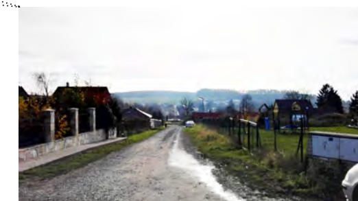
ŠPATNÝ STAV KOMUNIKACÍ
