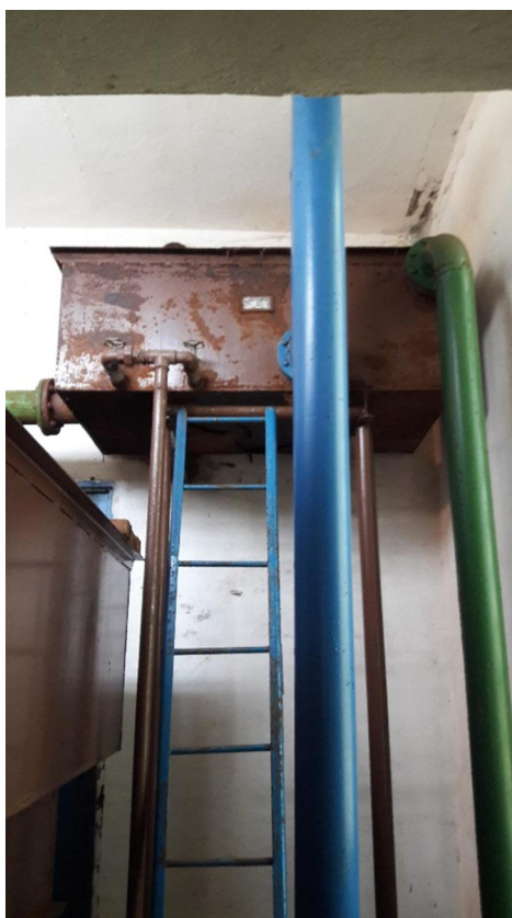
ÚV Radošovice - provzdušnění
