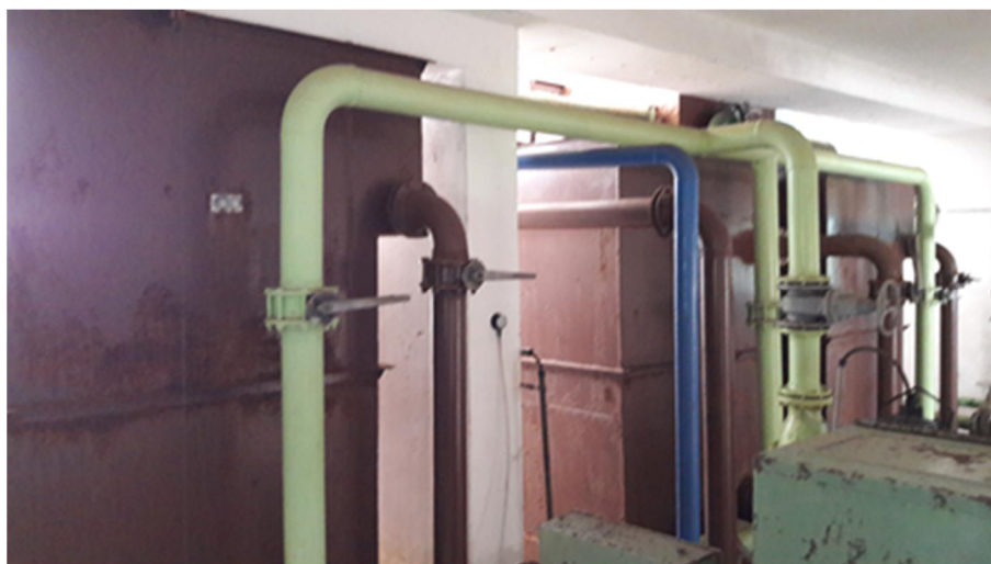
ÚV Radošovice - filtrace
